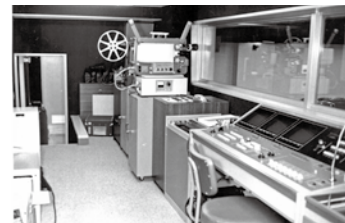
視聴覚ホール調整室の機器(当時)
